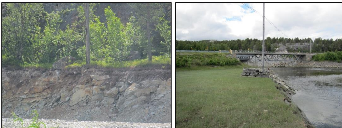
Figur 48: Stolper med skadet fundament. Bildet til venstre viser stolpe i skråning. Bildet til høyre viser stolpefundament som har rast ut i elva. Foto: Statens vegvesen.
