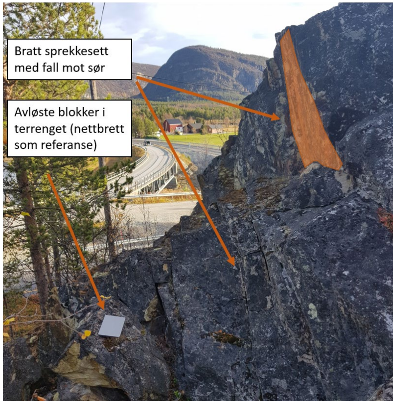
Figur 9 – Bilde av berg i dagen bak eksisterende skjæring til interimsvegen med markering av sprekkesett S1.
