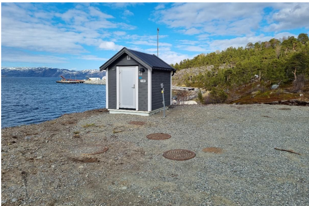
Figur 4 - Kommunal pumpestasjon sentralt i planområdet. Skiferkaia i bakgrunnen.
