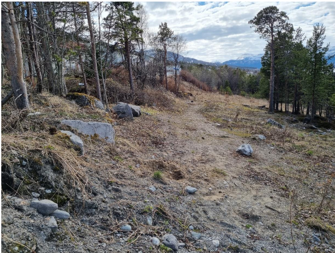
Figur 6 – Store spor etter graving i området rett nord for eneboligene i Kongsvikveien. Traseen ned til den kommunale pumpestasjonen sees borte til høyre i bildet.
