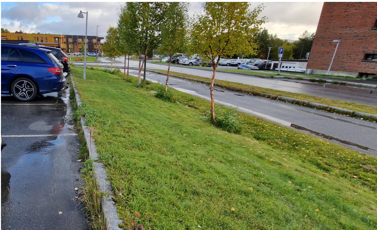
Figur 6-3. Grøft imellom parkeringsplass og Follumsvei i dag. Kilde: Rambøll AS Norge, Foto: Jørn Ivar Olsen
