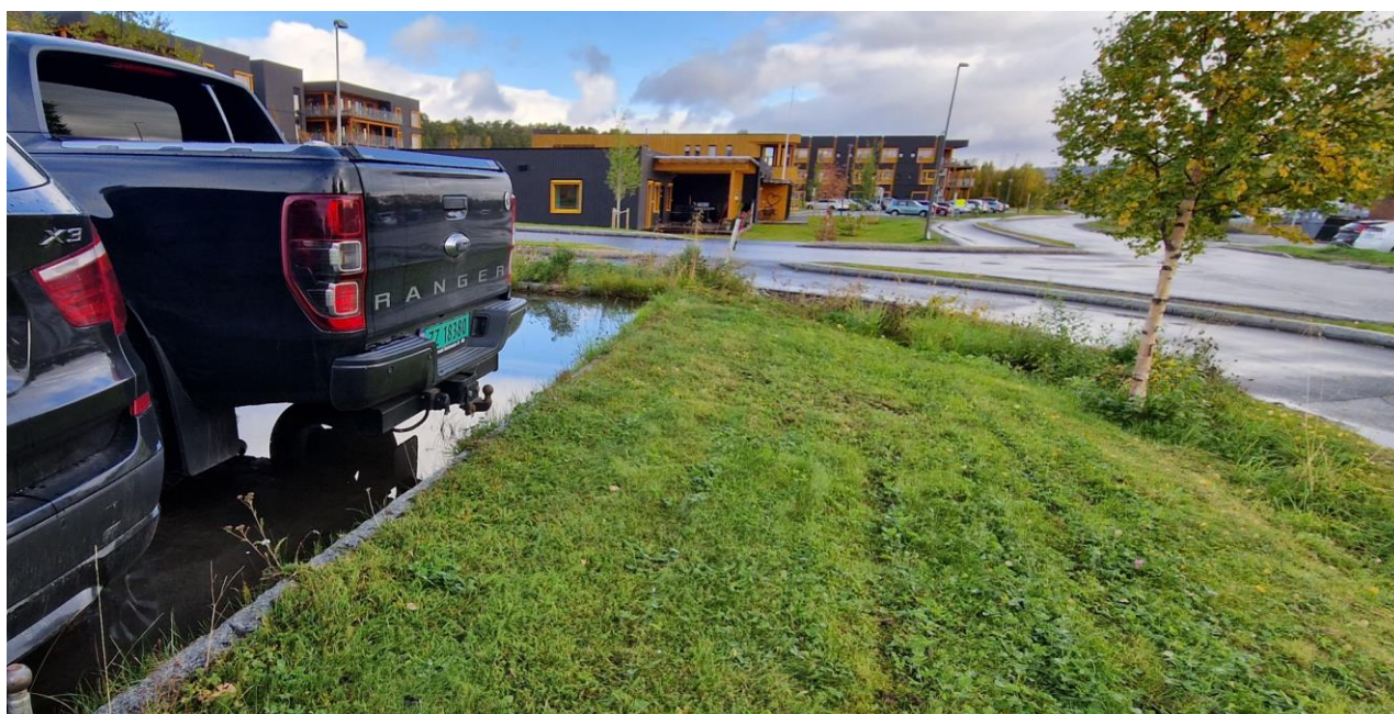
Figur 4-3. Bilde viser kantstein som hindrer overvannet til å renne ned i grøften. Kilde. Rambøll Norge AS, Foto: Jørn Ivar Olsen.
