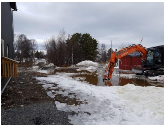
Bilde 1. Oversvømmelse av gang- og sykkelvei mellom Bekkefaret og Breverudtunet. Vannet hadde også nådd inn i tomtene langs Bekkefaret. Foto: Rambøll Norge AS.
