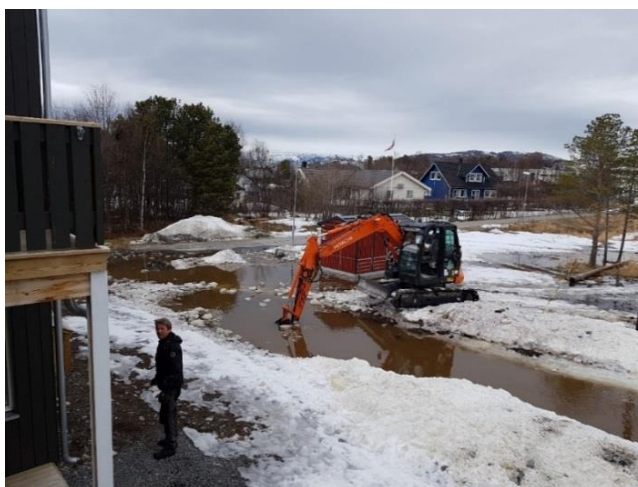
Bilde 2. Oppstuvning nord for BUL-banen. Foto: Rambøll Norge AS.
